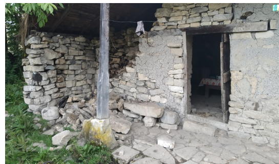
Figura 16. Refugi de Tajopampa moments després del terratrèmol
