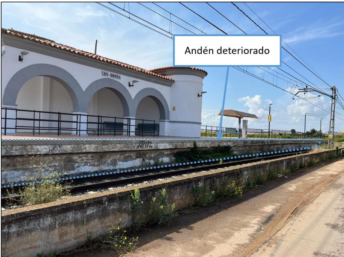
Figura 135. Andén deteriorado (Fuente: Elaboración propia)
