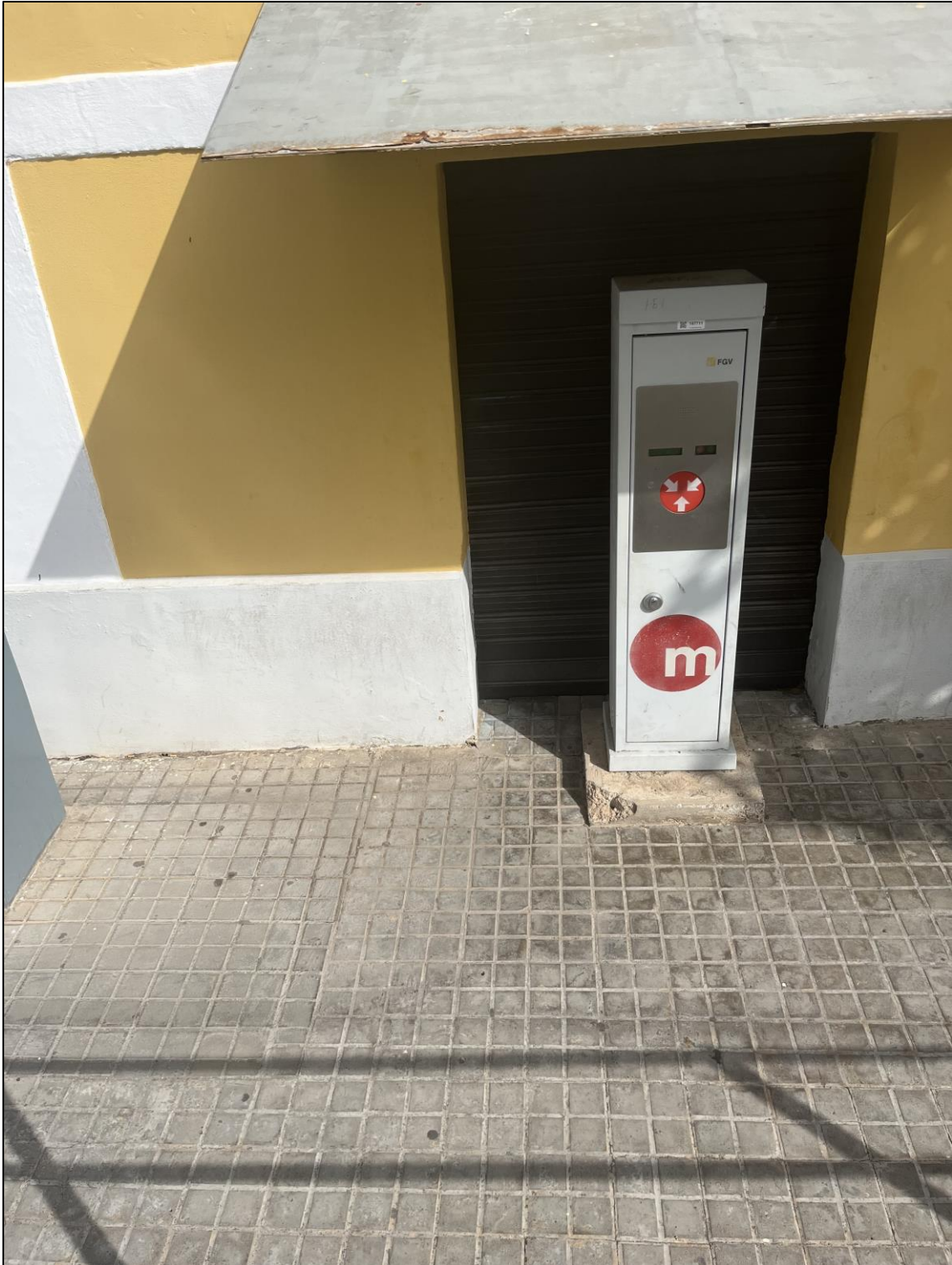
Figura 113. Infraestructura para la validación del ticket (Fuente: Elaboración propia)
