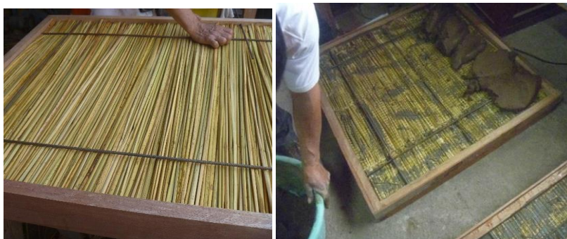
Figura 61. Colocación y Revestimiento primario de mortero de cemento y tierra tamizada Fuente: Ayarquispe Lopez Edison Cruz 2019
