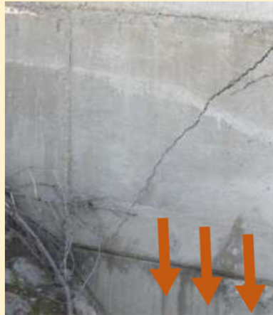
Figura 1. CURSO Diversas Patologías estructurales 2016 (FCCCO)
