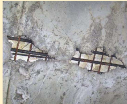
Figura 2. Informe Gral de Patologías M-30 I-1 (FCCCO)
