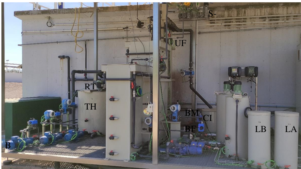
Figura 3.1. Fotografía de la planta piloto de Ultrafiltración. RT: Roto-tamiz. TH: Tanque de homogeneización. BA: Bomba alimentación. UF: Módulo de ultrafiltración. S-UF: Soplante de la Ultrafiltración. BM: Bomba de mezcla. BF: Bomba de filtración. CIP: Tanque de almacenamiento del permeado. LB y LA: Tanques de limpieza básica y ácida, respectivamente.
