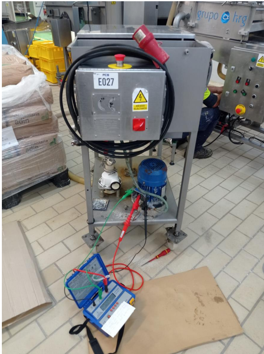
Figura 68: Ejecución de ensayos de medidas de resistencia de aislamiento en motor CEMER
