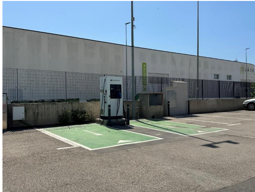
Fotografía 111: Estación de recarga de vehículos eléctricos en estación de servicio Valcarce. Fuente: Elaboración propia.
