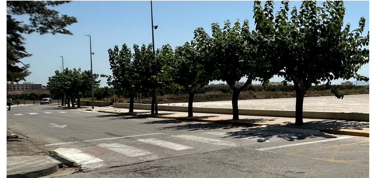
Fotografía 106: Resalto deteriorado del “Camí dels Depòsits” en la entrada al centro privado “La Devesa”.
