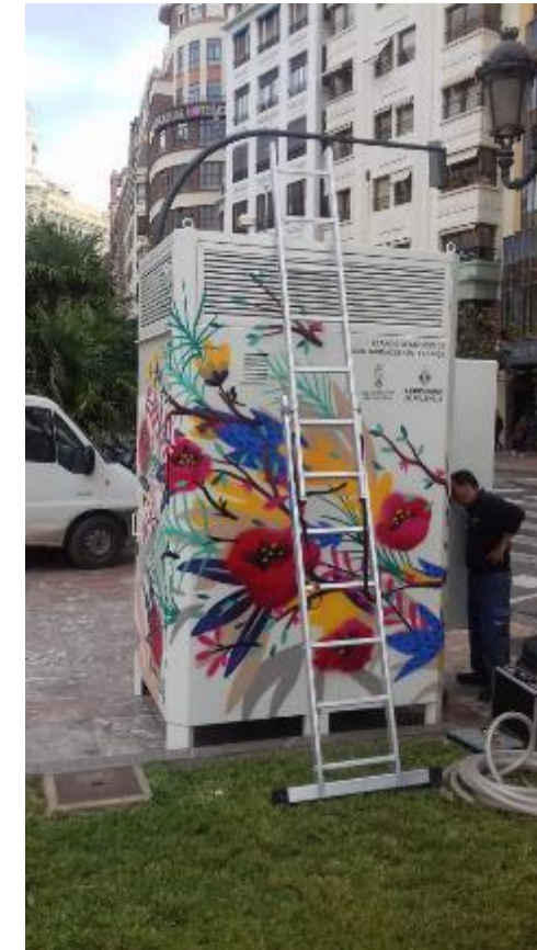
Fotografía 112 Ejemplo de Estación de Control de la Calidad del Aire en la ciudad de Valencia.
