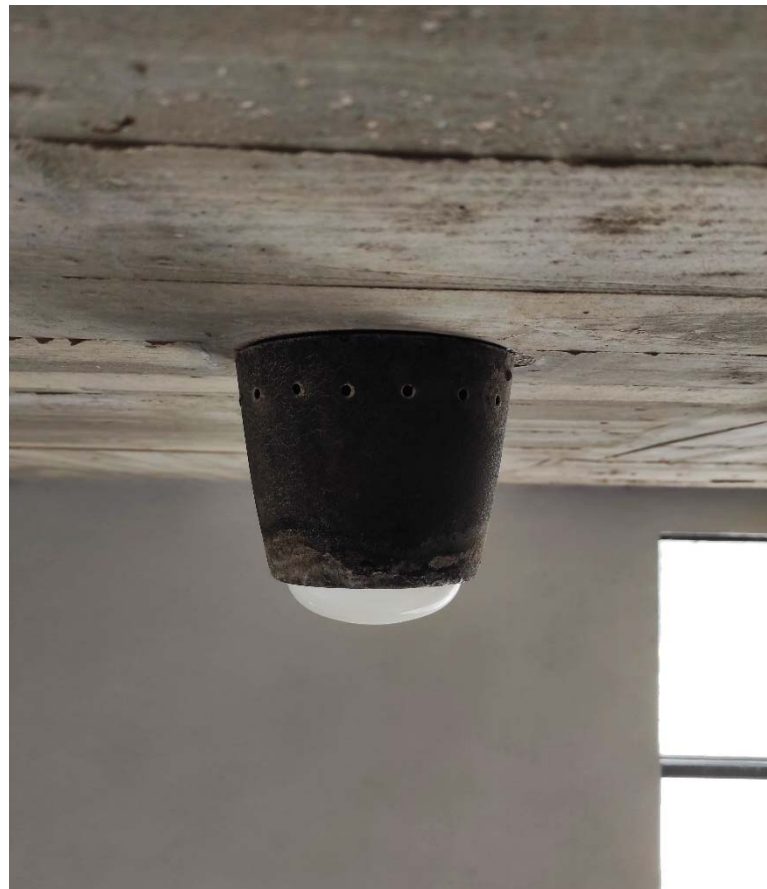
09. 28 Fernando Moreno Barberá, ULC (1967). Paraninfo. Fotografía de las de la luminaria exterior © Ivo Vidal & Ciro Vidal. (mayo 2021)
