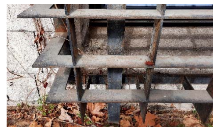
05. 13 Fernando Moreno Barberá. Facultad de Ciencias Biológicas y Geológicas, Madrid (1964-68). Detalles cerrajería. © Fernando Usó Martín (2022).
