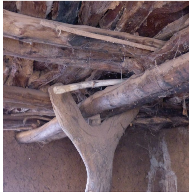
Plancher d'une habitation bobo constitué d'une poutre, de solives transversales et de troncs et d'écorces percés.
