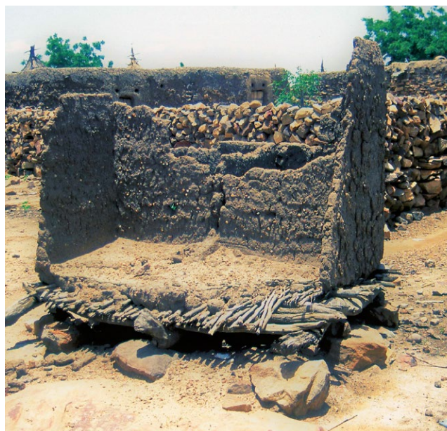
Grenier dogon dans un état de semi-ruine en raison d'un manque d'entretien et de réparations, permettant ainsi d'observer parfaitement sa partie constructive.
