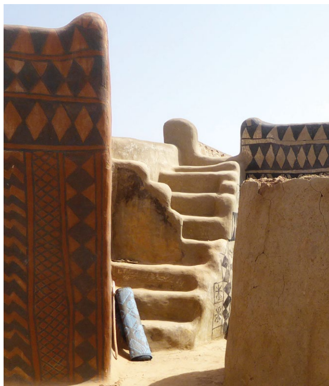
Escalier suggestif en maçonnerie d'une habitation kassena avec un garde-corps intermédiaire transversal en escalier afin de distinguer les marches du bas, également utilisées comme bancs pour s'asseoir, des marches du haut pour accéder au toit-terrasse.
