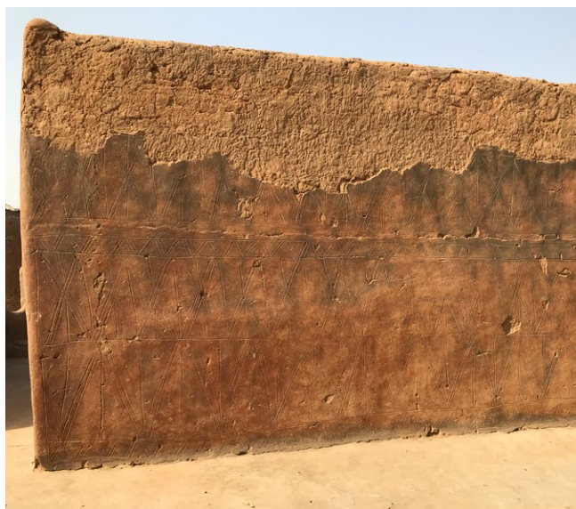
Décollement de l'enduit incisé et peint dans une maison de la Cour royale de Tiébélé, probablement dû à l'humidité de la pluie.
