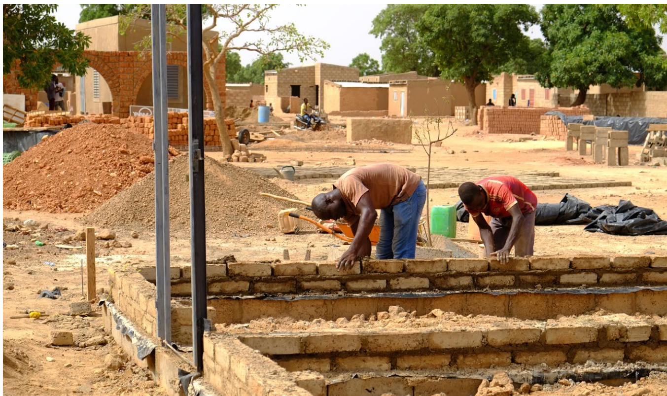
Construction de bâtiments dans le cadre du projet d'amélioration du quartier de Boassa.
