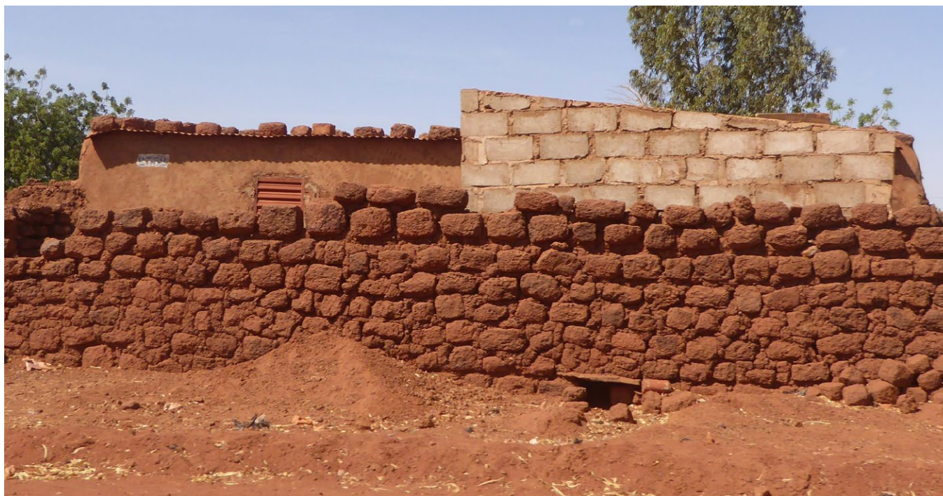
Mur de pierres latéritiques taillées et mur de blocs de béton préfabriqués.
