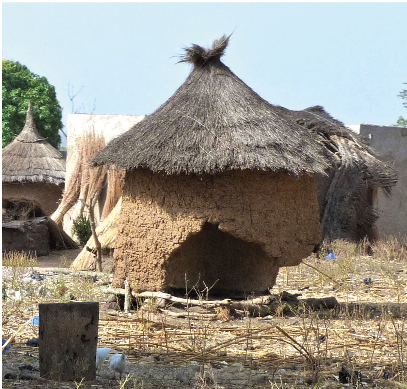
Brèche dans une case aux murs de terre dans un village gan, causée par un effondrement, probablement dû à un excès d'humidité.
