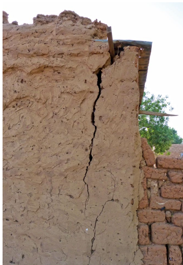
Fissuration d'un angle due à l'absence d'un bon ancrage entre les deux murs convergents.
