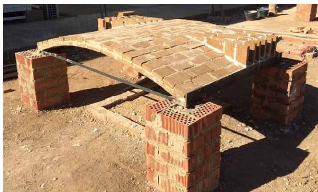
Détail de construction type de la solution calculée. Voûte en BTC, formation de la surface praticable, système de hauban horizontal et point de contact avec le mur.
