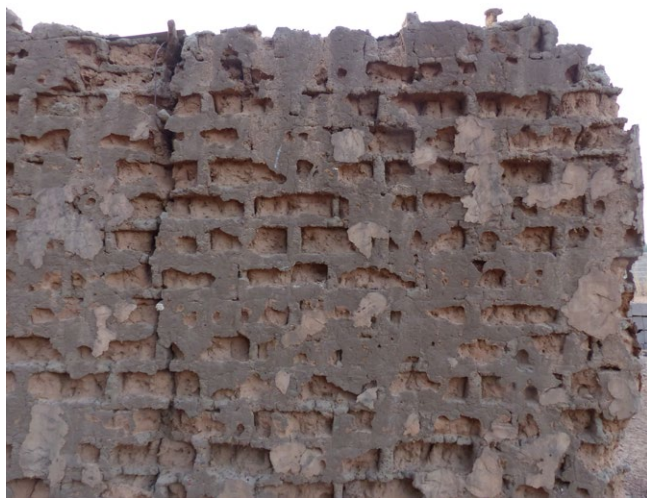
Joints et enduit au mortier de ciment sur le mur en adobe qui consomme peu à peu le corps du mur construit en terre, en raison de l'incompatibilité entre les deux.
