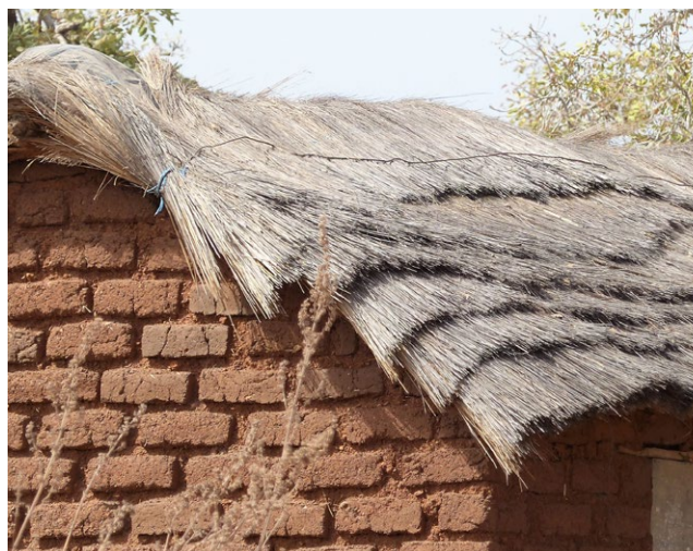
Toiture végétale rare à deux versants constituée de couches superposées de fagots de paille sur une case rectangulaire gan.
