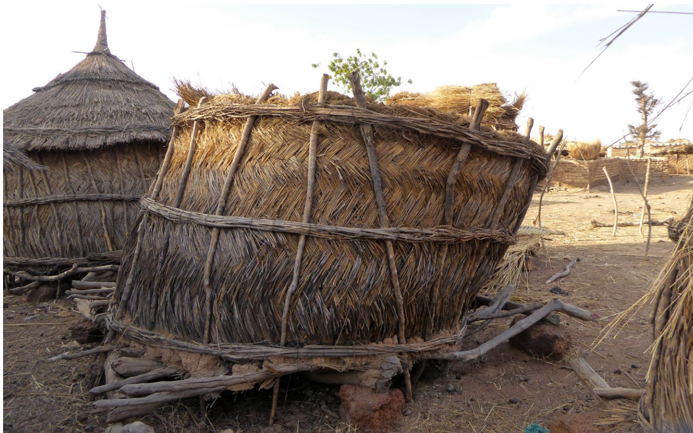
Silo mossi de paredes vegetales que ha perdido su compostura por haberse aflojado sus flejes de lianas y haberse movido la empalizada perimetral.
