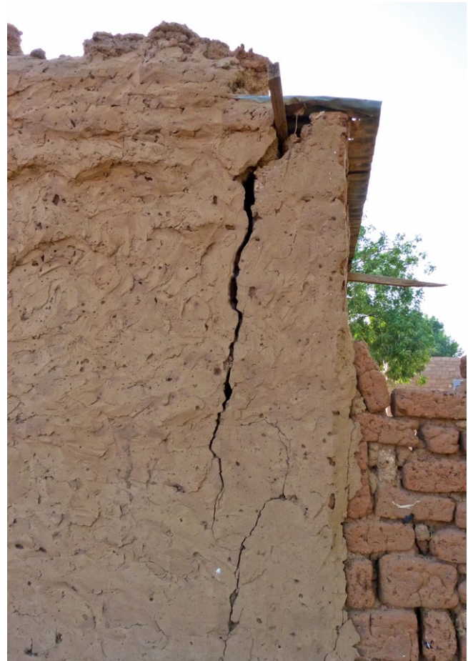
Agrietamiento de una esquina por falta de una buena traba entre los dos muros confluyentes.
