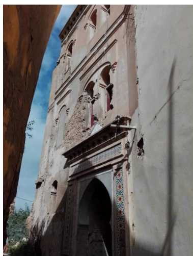
Fig. 6 : Tobbana, Le vieux bâti abandonné se désintègre. Source : Auteur
