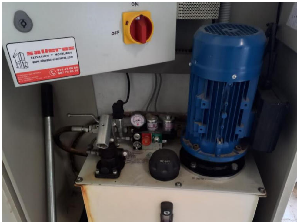
Ilustración 34. Motor eléctrico con bomba hidráulica
