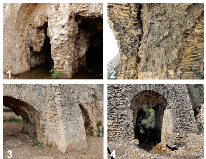
Figura 8. Refuerzos de las pilas. 1: Refuerzo del tramo central por un peso excesivo de la estalactita. 2: refuerzo de la bóveda por ambos frentes, realizado a mediados del siglo XX. 3: Refuerzo con un contrafuerte de mampostería y un arco de ladrillo, siglo XVI o XVII. 4: Refuerzo de pilas, bóveda y muro superior mediante contrafuerte de mampostería, siglo XIX.
