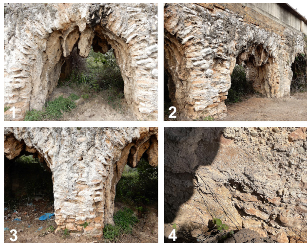
Figura 7. Arcos originales, no afectados por intervenciones posteriores. 1: Arco 19 formado por piezas irregulares de sillarejo con formación de estalactitas. 2: Vista de los arcos 19, 20 y 21 sobre los que apoya un muro de ladrillo de época posterior. 3: Pila 19-20 de sillarejo de piedra caliza a soga. 4: Restos del recubrimiento original.
