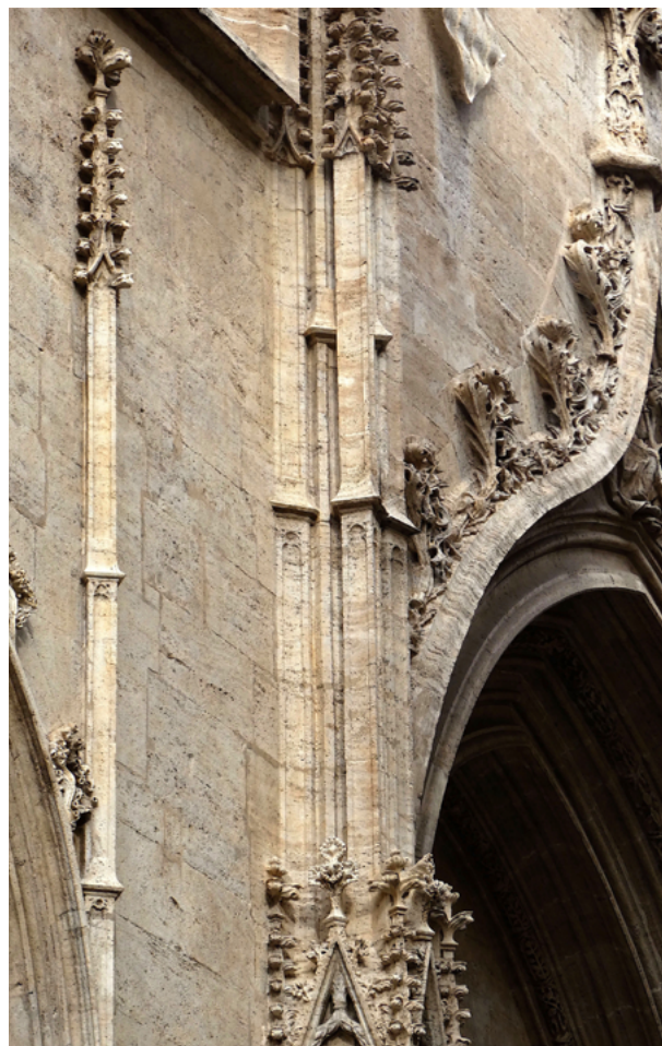
FIGURA 8. Semipináculos de una ventana y de la portada emergiendo del muro en la fachada posterior de la Lonja de València
