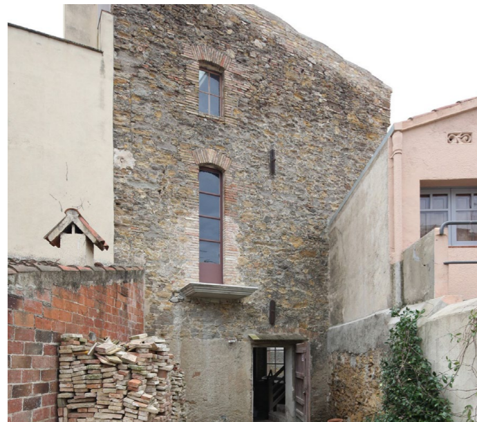
Figura 16. Estado de la entrada sur antes de la intervención.
