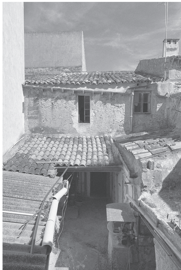
Figura 37. Imagen de la vivienda y el patio antes de la intervención.
