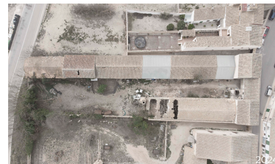
Imatge 56. Estat actual, part de la bodega amb la coberta i forjat enfonsats, també part del bloc d'oficines.
