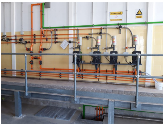
Figura 14. Bomba de impulsión coagulante. (Fuente: Propia.)
