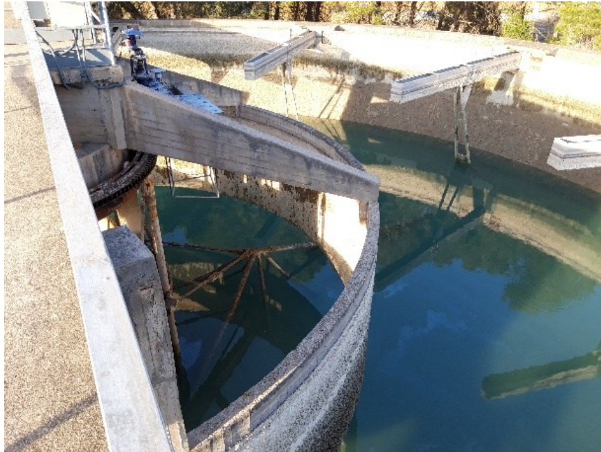
Figura 5. Decantador circular Alta 1. (Fuente: Propia).
