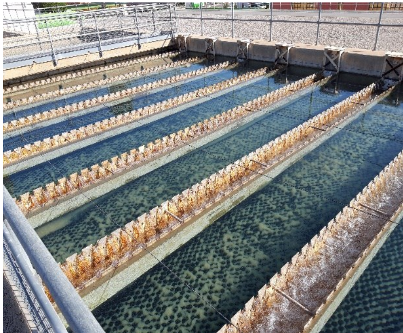
Figura 6. Decantador Densadeg Alta 2. (Fuente: Propia)
