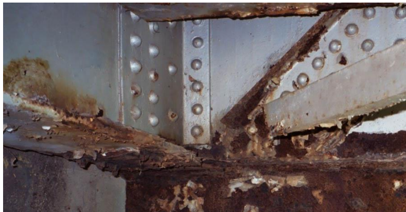
Figura 3. Corrosió a una unió de perfils metàl·lics.
