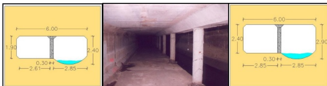
IMAGEN 25. SECCIONES TRANSVERSALES DEL COLECTOR NORTE TRAMO I. LA SECCIÓN DE LA IZQUIERDA PERTENECE A LAS CERCANÍAS DEL PUENTE EXPOSICIÓN. FUENTE: TFG COLECTOR NORTE DE PABLO CABO LÓPEZ, AÑO 2017.
