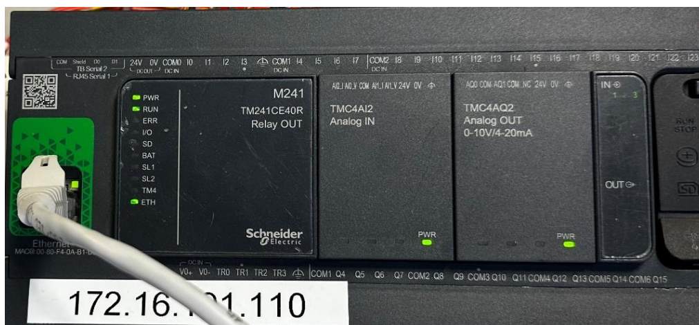
Figura 24. Imagen del PLC en el laboratorio de la UPV.
