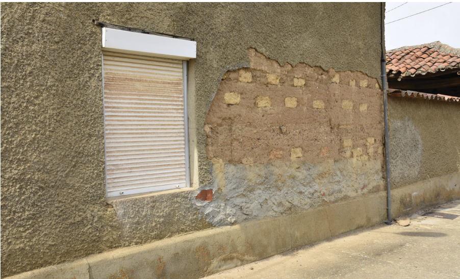
Figura 52: Revestimiento e integraciones con cemento en un muro de tapia careada con adobes en Molezuelas de la Carballeda (Zamora), junio 2022.
