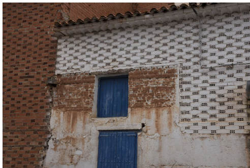
Adobes que se han parcialmente conservados en una porción del muro, mientras que en el resto del edificio se han sustituido por ladrillos industriales. Abril 2023
