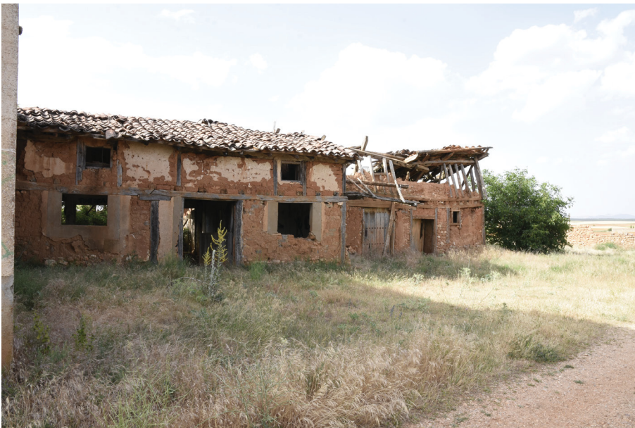
Figura 60: Edificio de entramados rellenos de adobes en Escobosa de Catalatañazor, un barrio de Rioseco de Soria que se abandonó en los años setenta del siglo pasado. Junio 2022. El edificio y el resto del conjunto padecen de un avanzado estado de degradación y ruina consecuente al abandono producido. Junio 2022.
