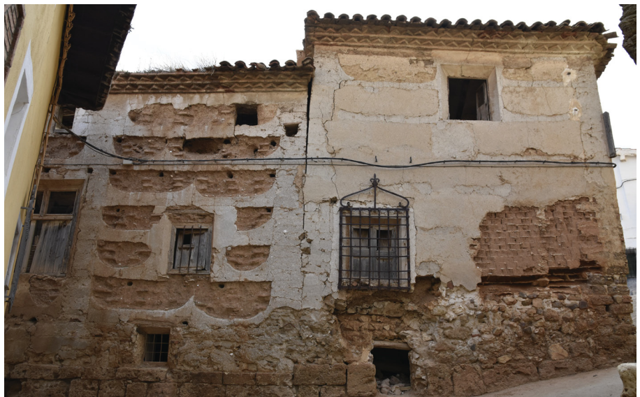
Figura 43: Edificio de técnicas mixtas de tierra en Fuentes de Jiloca (Zaragoza). El edificio sufre especialmente de erosión profunda, deformaciones, pérdidas de elementos, etc., lo cual ha mermado significativamente su estado estructural. Abril 2023.
