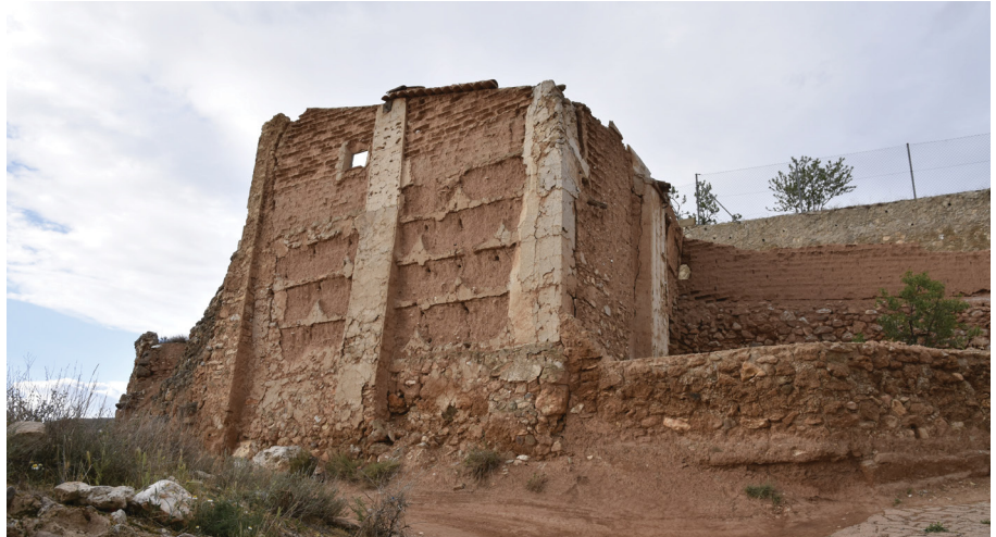
Figura 42: Edificio de tapia y adobes en estado de ruina avanzado en Fuentes de Jiloca (Zaragoza). Se aprecian grietas, erosión profunda y superficial, pérdida de la costra y deformaciones. Abril 2023.
