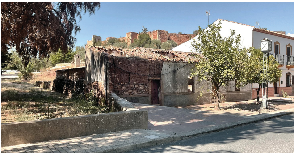
Figura 70: Niebla (Huelva), muralla y casas de tapia. Se aprecia a primera vista una diferencia significativa en el estado de conservación, que generalmente se ha observado en todo el conjunto. Junio 2021.
