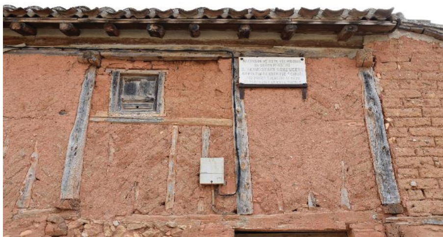
Figura 48: Edificio de entramados de madera y adobes inclinados en Boós (Valdenebro, Soria). Se observa una buena conservación general tanto de la estructura como de los revestimientos en ausencia de intervenciones. Junio 2022.
