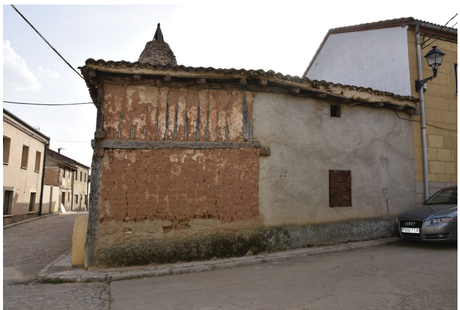
Figura 44: Edificio en adobes y entramados en Valdenebro (Soria) con grietas, erosión y pérdida de material. Junio 2022.
