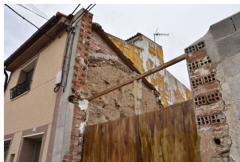
Conservación de la estructura de tapia en la medianera de un edificio. Se aprecia la sustitución ocurrida en las restantes partes. Abril 2023
