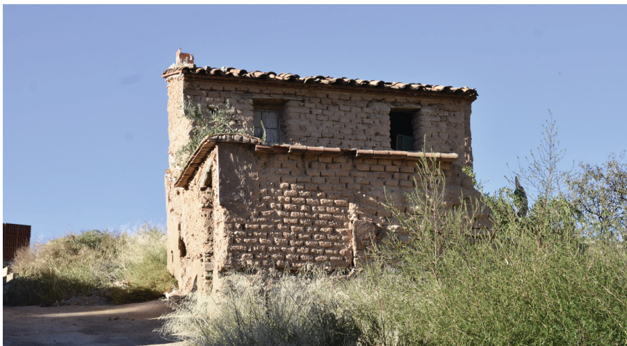
Figura 35: Edificio de adobes en Chodes (Zaragoza), octubre 2021.
