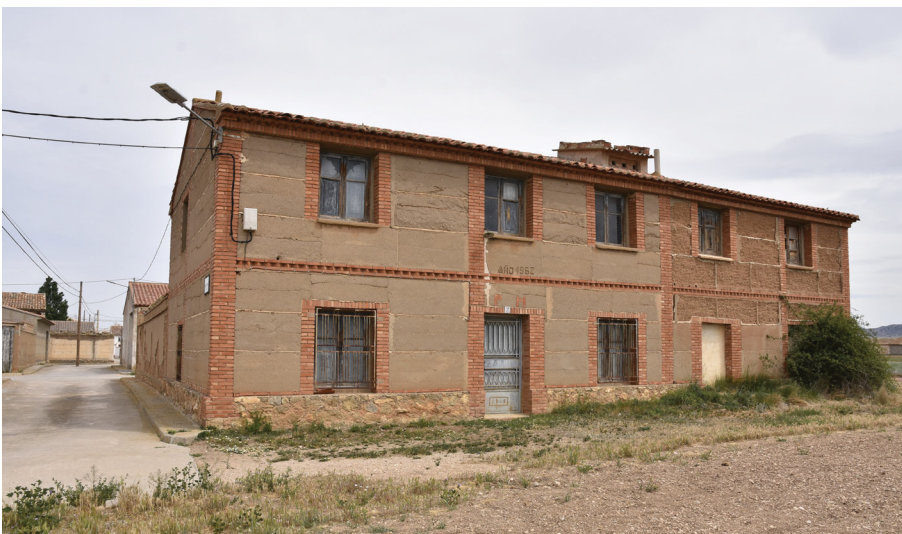
Figura 53: Revestimiento con cemento en los cajones de un edificios de tapia suplementada en las juntas en Torremocha de Jiloca (Teruel), abril 2023.
