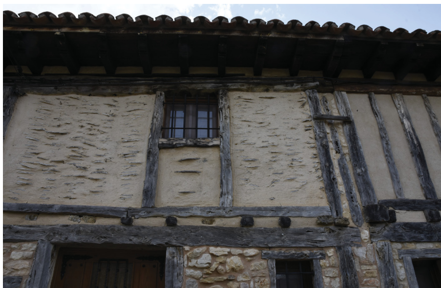
Figura 49: Edificio con zarzo intervenido mediante integración del mortero realizada con técnicas tradicionales en Calatañazor (Soria), junio 2022.
