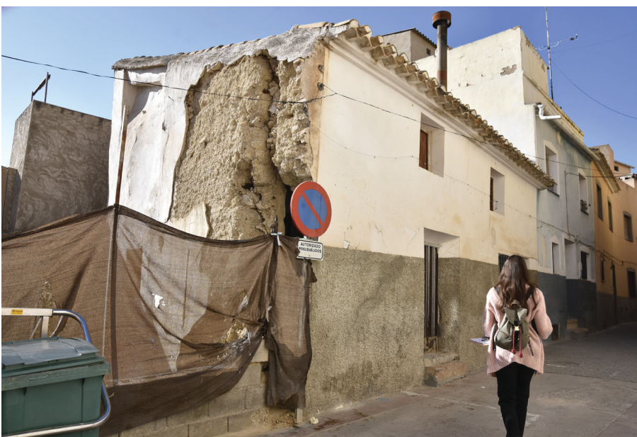
Figura 41: Edificio de tapia en estado de ruina avanzada. Entre las numerosas patologías presentes, destacan sobre todo la pérdida de sección, las deformaciones y las grietas. Mula, marzo 2021.
