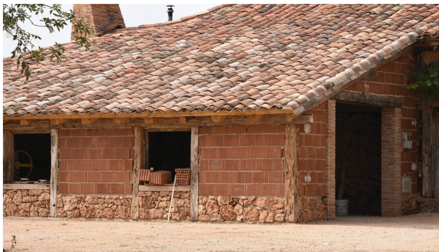
Figura 54: Sustitución del relleno en adobes por ladrillos huecos en un edificio de entramado de madera en Rioseco de Soria (Soria), junio 2022.
