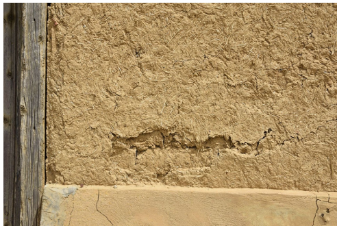
Detalle del trullado en un edificio de adobes. Junio 2022
