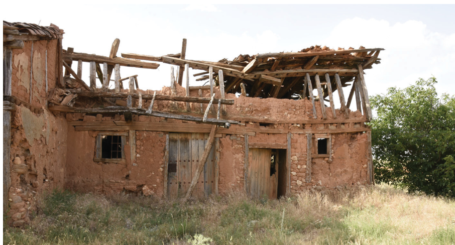
Figura 45: Edificio con entramado de madera relleno de adobe y piedra en estado de ruina en Escobosa de Calatañazor (Rioseco de Soria): la pérdida elevada de material así como las deformaciones existentes causan que sea necesaria una intervención de dimensión considerable para restaurar el edificio a un estado adecuado que permita su uso. Junio 2022.
