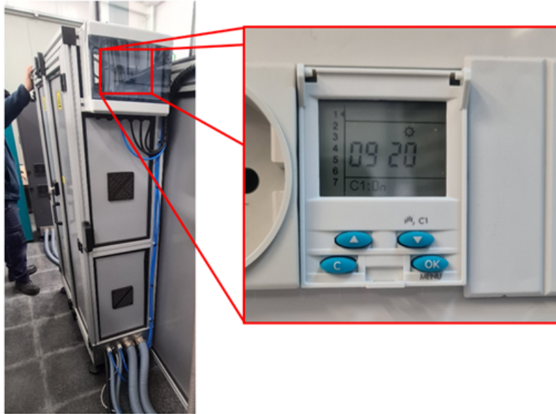
Figura 3.11: Panel de control para la programación de la unidad de almacenamiento y acondicionamiento de material.
