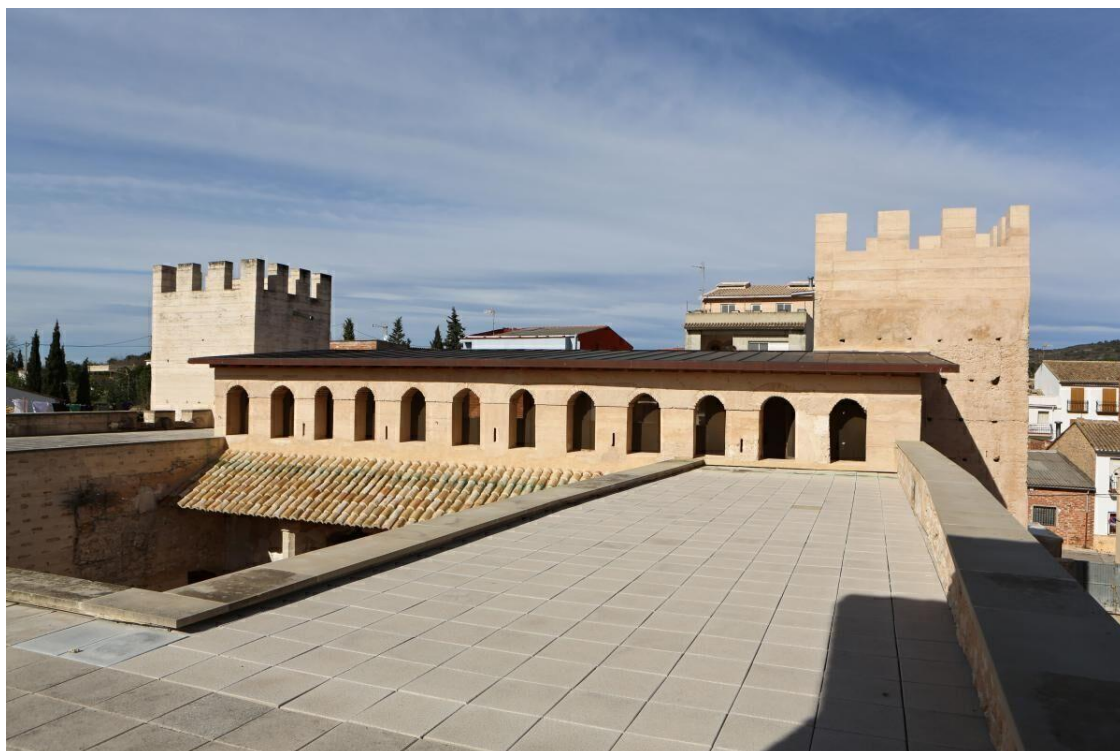
Ilustración 38: Estado de la cubierta en la actualidad
