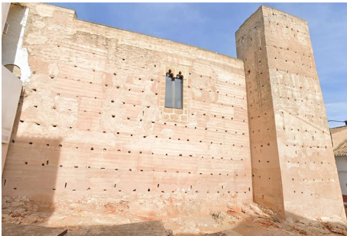
Ilustración 37: Estado de la cara oeste del castillo palacio en la actualidad 49
