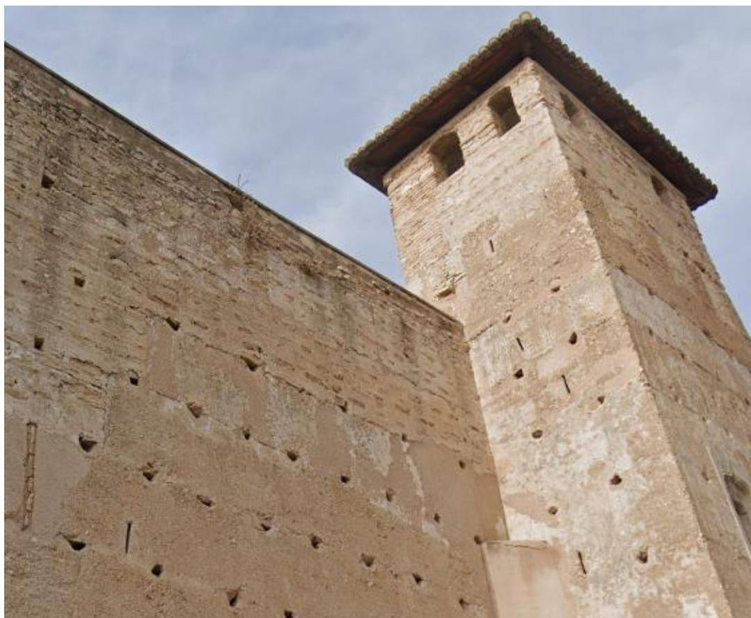
Ilustración 24: Fotografía de la fachada principal del castillo palacio de Llutxent mostrando el estado actual de la tapia de esta cara del edificio. Se puede apreciar los agujeros del retirado de las agujas en el proceso de ejecución de una tapia mediante método tradicional. Además, se puede vislumbrar el estilo de la tapia del castillo el cual sería de tapia valenciana, característico por los ladrillos vistos. Autoría: Street view de Google Maps
