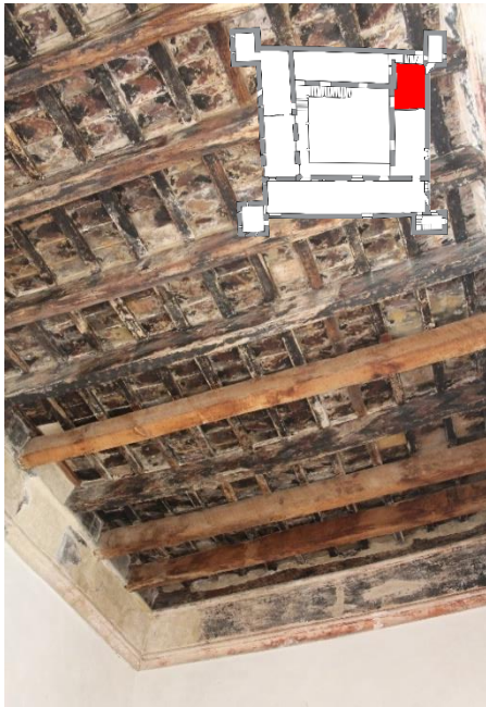
Ilustración 46: Estado de la techumbre de la sala del ala sur, con el alfarje pendiente de restaurar y con viguetas nuevas debido al mal estado de las anteriores
