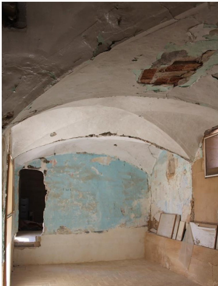
Ilustración 25: Bóveda tabicada con ladrillos expuestos en la planta señorial del ala norte del castillo palacio de Llutxent. Autoría propia 30
