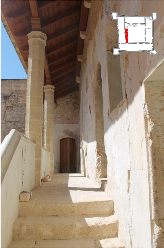
Ilustración 40: Estado actual del pasillo exterior de la planta noble, mostrando el estado de las columnas y del tejado que evacua sobre el patio
