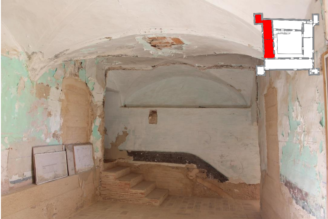
Ilustración 49: Fotografía de la habitación derecha del ala norte, con señales de desconchamiento de las paredes
