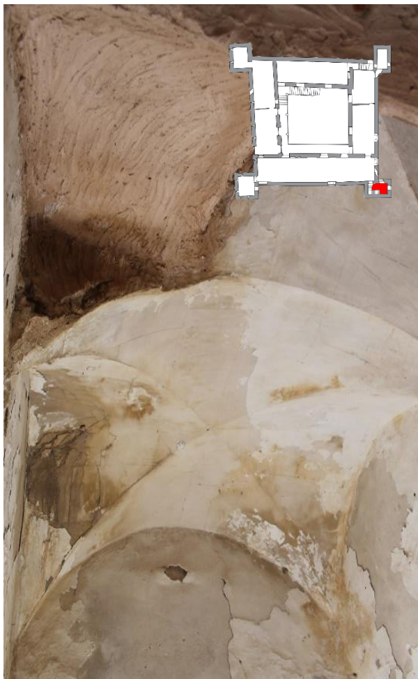
Ilustración 44: Estado de la techumbre de bóveda tabicada aristada de la torre suroeste, mostrando claros indicios de problemas de suciedad relacionados con la presencia de humedad
