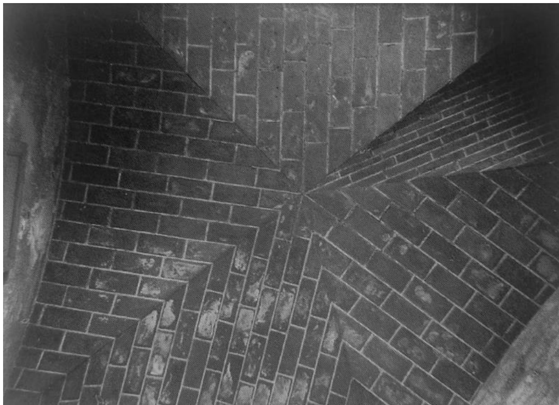
Ilustración 28: Bóveda aristada de ladrillo cortado en el monasterio de la Trinidad de Valencia (1460) 39
