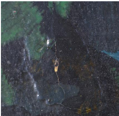
Figura 36. Macrofotografía de una hinchazón debido a la oxidación de los clavos. Daño central (2 x 3,5 cm)
