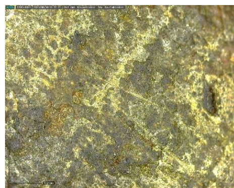
Figura 47. Detall de la corrosió en la làmina metàl·lica 2.. Foto Pròpia realitzada amb DinoLite
