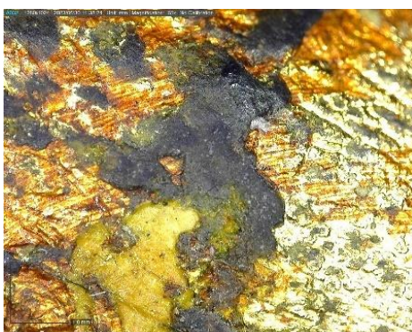
Figura 46. Detall de la corrosió en la làmina metàl·lica. Foto Pròpia realitzada amb DinoLite
