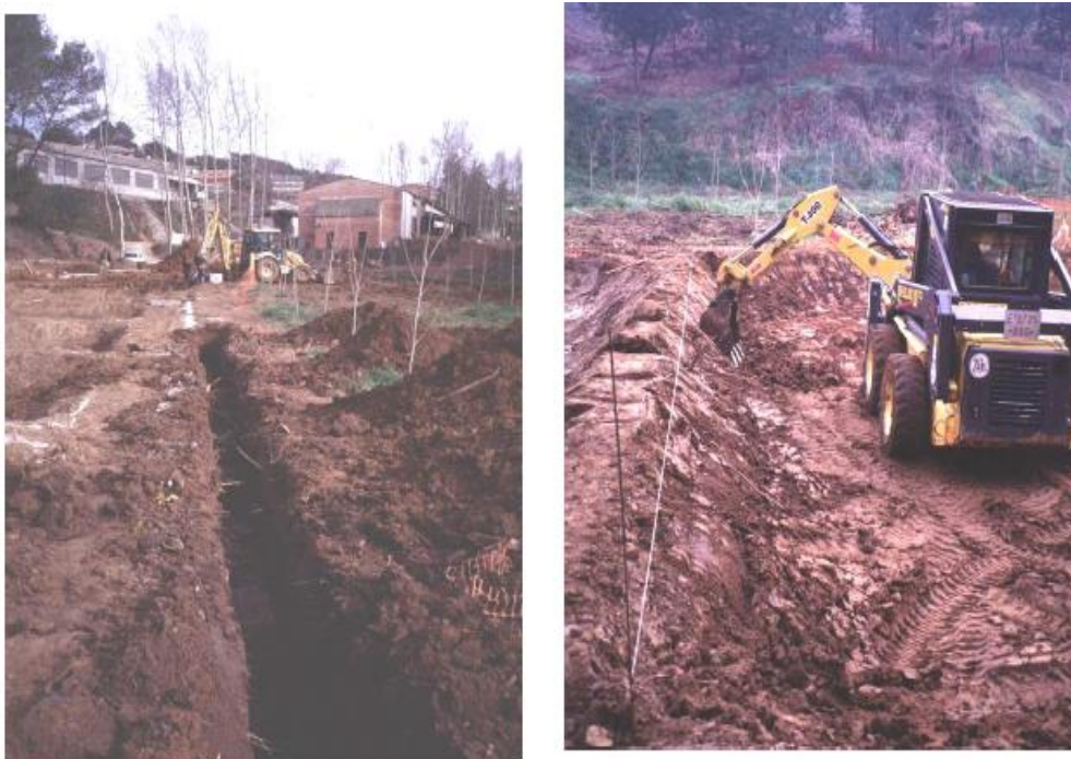
Figura 17. Excavación de una zanja para la colocación de una tubería y excavación y conformación de taludes durante la construcción de un sistema de humedales construidos.
