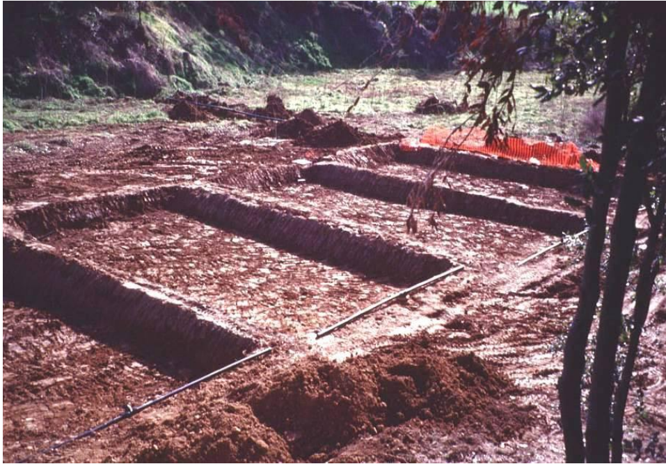
Figura 18. Conformación de los taludes de las celdas de un sistema de humedales. En este caso las celdas se construyeron por excavación.
