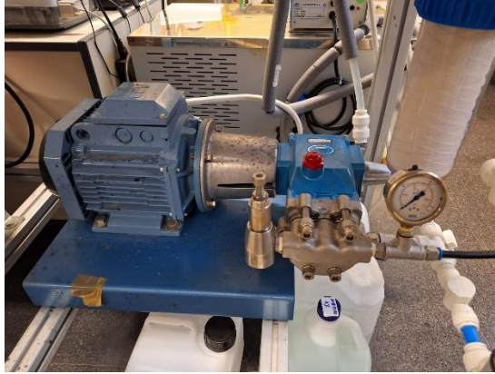
Figura 22 Bomba planta piloto
