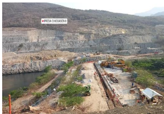
Figura 30: Infraestructura actual de la Central Chicoasen II. Fuente: (Anónimo, 2023)
