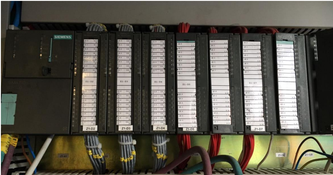
Figura 20 autómatas maestro de una grúa RTG (Villodres Martín, 2017)
