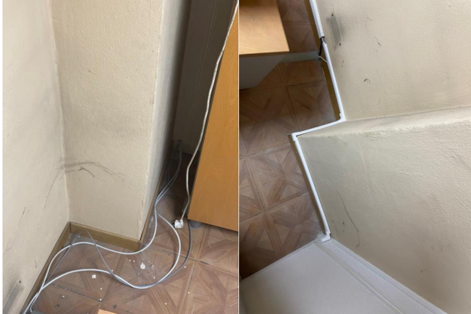
Il·lustració 80 - Cablejat Oficina
