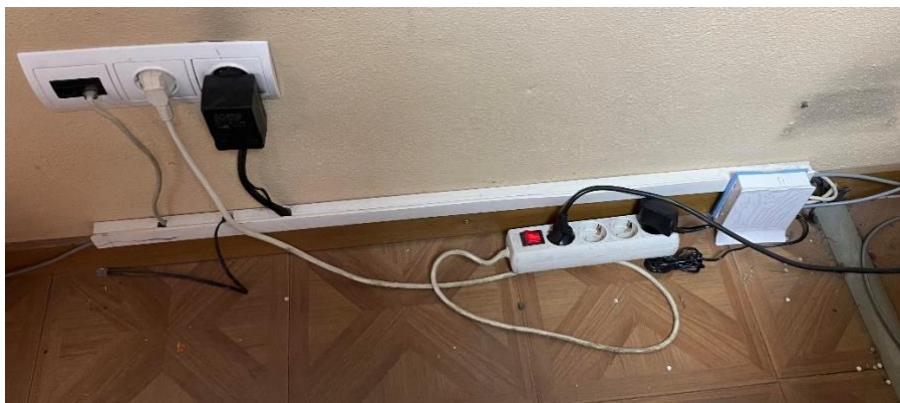
Il·lustració 32 - Router Actual
