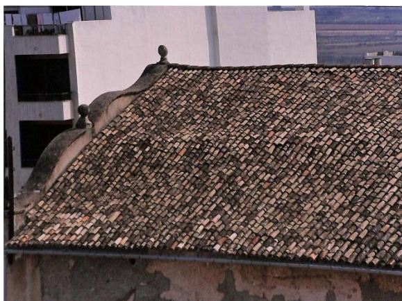
Fig. 30 Estat del teulat part dreta.
