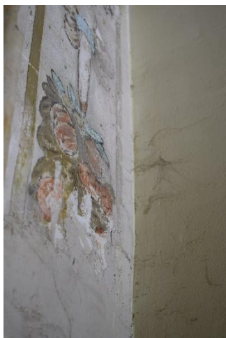
Fig. 42 Acumulació de brutícia, teranyines.
