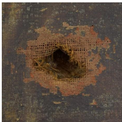
Figura 47: Detalle de daños ocasionados por el impacto de balas en la guerra civil española.
