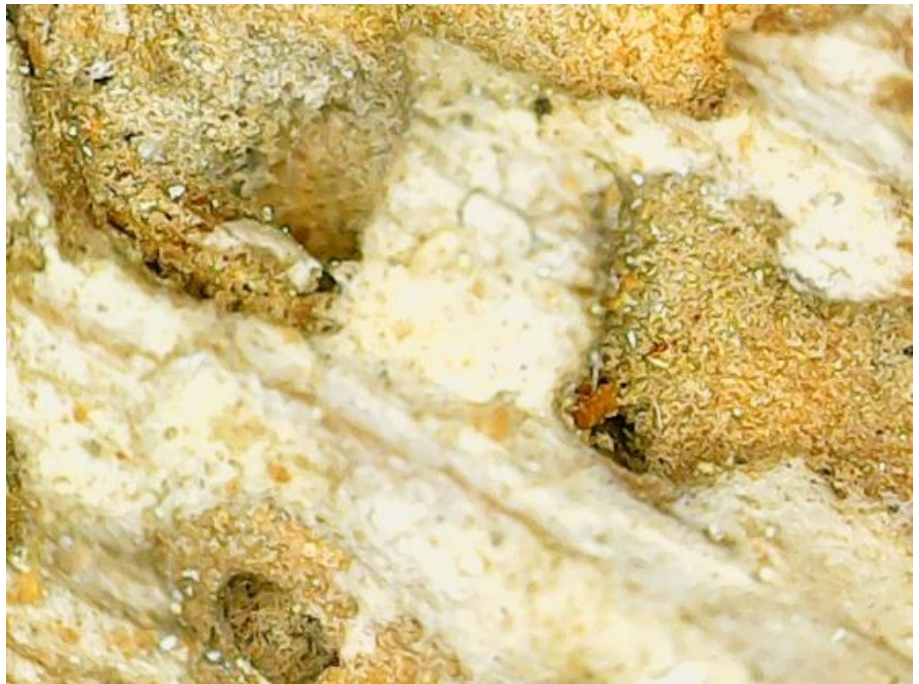
Figura 30. Galerías provocadas por los xilófagos
