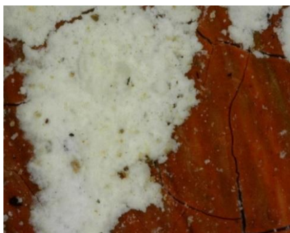
Figura 42- Detalle depósito de yeso.
