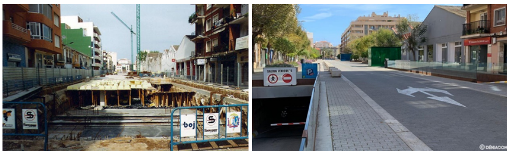
Figura 11-14. Cronología carrer La Vía. Fuente imagen 11 y 13 (2003): “lamarinaplaza.com” (García, 2020). Fuente imagen 12 (2002) y 14 (2021): “denia.com” (Moncho,2023;2021).
