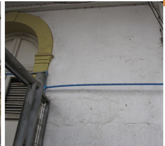
Imagen 140: Cañería Fuera de Norma. Fuente : Elaboración Propia
