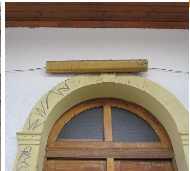
Imagen 148: Estado General de Ventanas. Fuente : Elaboración Propia
