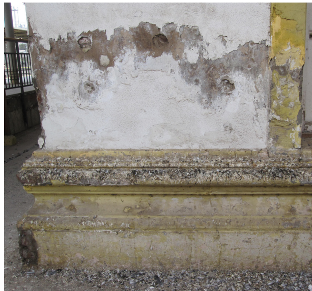
Imagen 139: Eflorescencia, Erosión y Desprendimiento Fuente : Elaboración Propia
