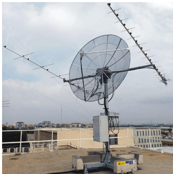
Figura 49. Montaje antenas sobre la estación terrena.
