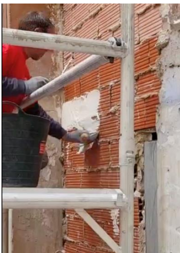
Figura 6. Aplicación del mortero de cal en el reverso de la obra. Foto de Vladimir Na
