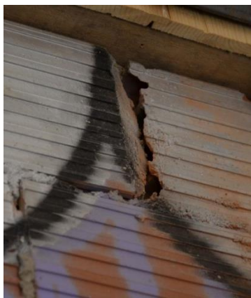
Figura 39. Foto detalle de separación de ladrillos del soporte. Foto de Mercedes Sánchez
