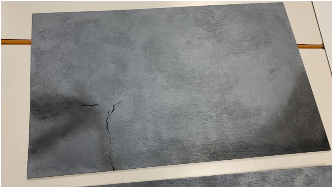
Figura 13. Pared con acabado de hormigón, humedades y grietas (2024).
