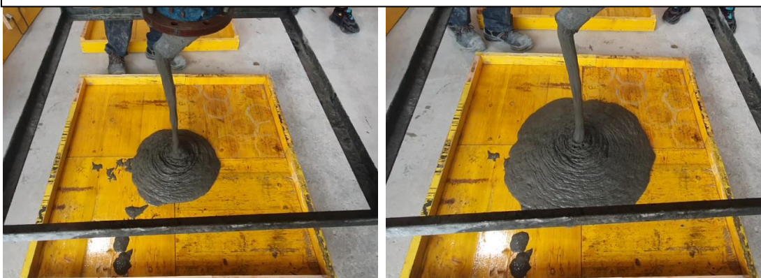
c) Hormigonado con posición fija en el centro de la losa (CP)
