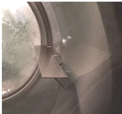
Figura 11. Deflectores del reactor.
