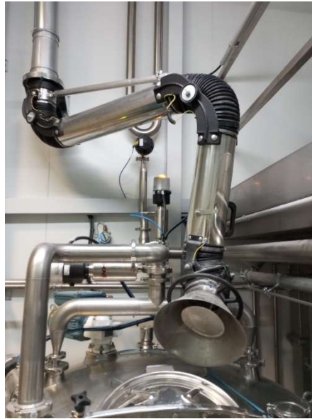
Figura 6. Aspiración de polvos del depósito exterior PM1.
