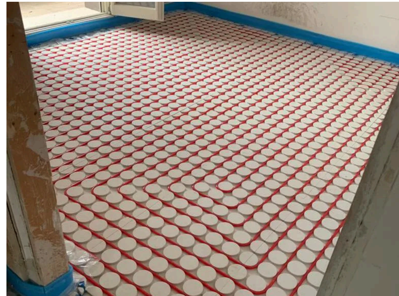
Figuras 34. Suelo radiante
