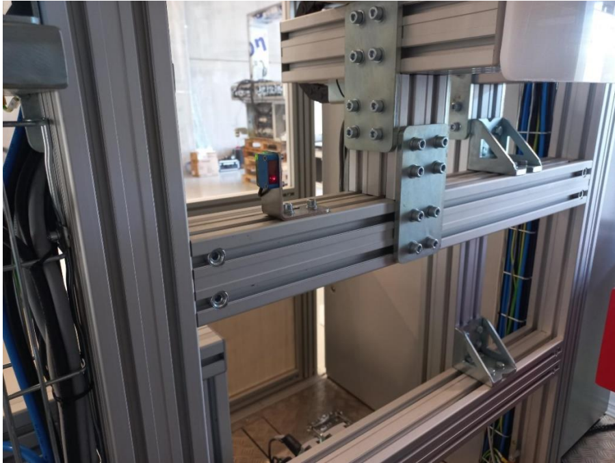
Figura 40. Fotocélula de detección de apertura de puerta del microondas
