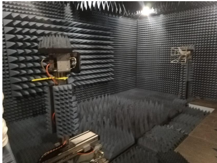
Figura 5.4. Cámara anecoica electromagnética
