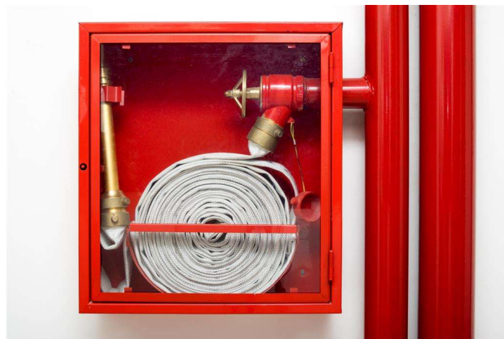
Figura 19. Boca de incendio equipada (BIE).
