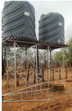
Figura 8.5: Infraestructura para bombeo de agua en Zimbabwe
