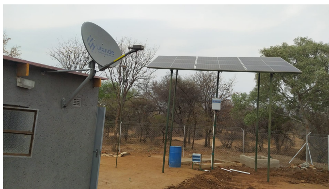
Figura 8.4: Infraestructura solar en Zimbabwe
