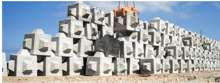
Figura 45 Ejemplo de colocación de las piezas en el acopio. Fuente: Web del Cubipod.
