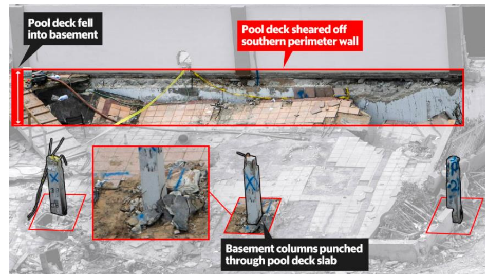
Figura 29. Elementos estructurales del edificio tras el colapso. [21]
