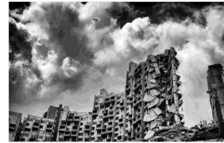
Imagen 3. Colapso de la torre nº6 del complejo del Edificio Space [3].
