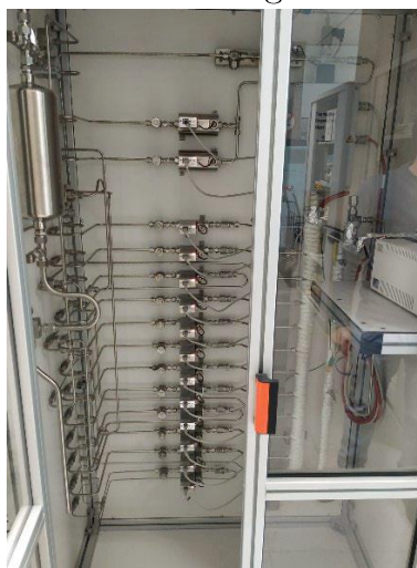
Figura 2.6. Generador de gas del banco de gases sintéticos.
