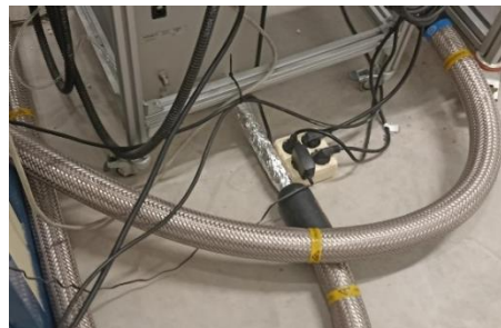
Figura 2.8. Tubería calefactada grande.
